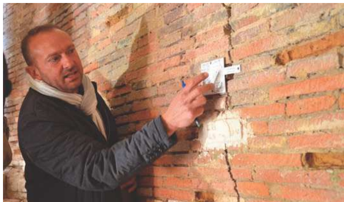
Frédéric Tranchant, gérant des Compagnons, en train de montrer une fissure du Fort Boyard.
